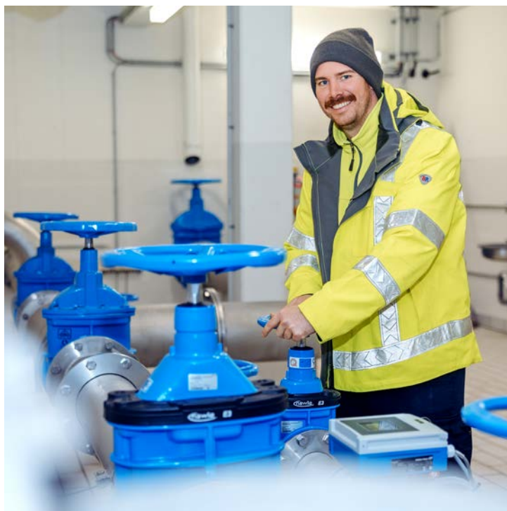
Technisches Wissen, handwerkliches Können und viel Gespür für die Wasserversorgungsanlage: All das braucht Thomas Kienmeyer im Beruf Wassermeister.
